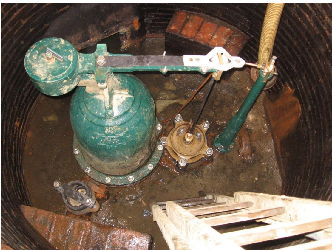
Photo du mécanisme du Béliet Hydraulique Bollée d'Andrezé après rénovation en 2008
